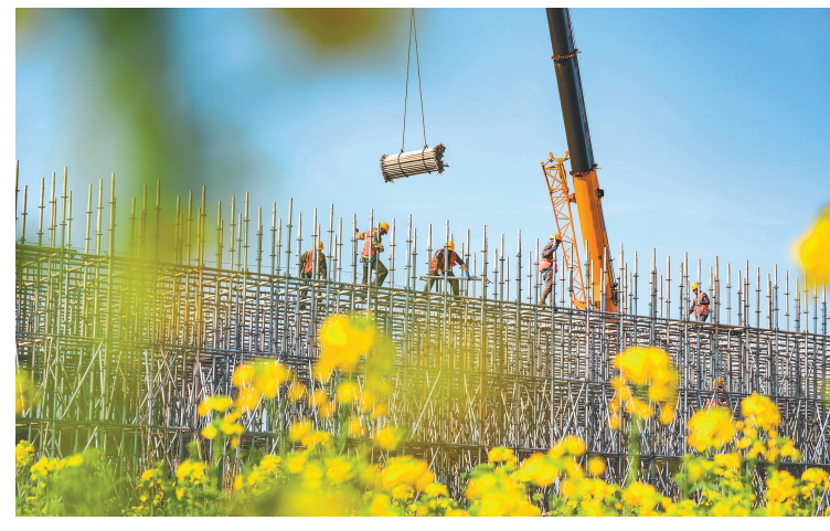
3月18日，中铁四局新建沪宁合高铁合肥枢纽建设现场一派繁忙景象。施工人员抢抓春季有利天气，高标准高质量推进项目建设。
