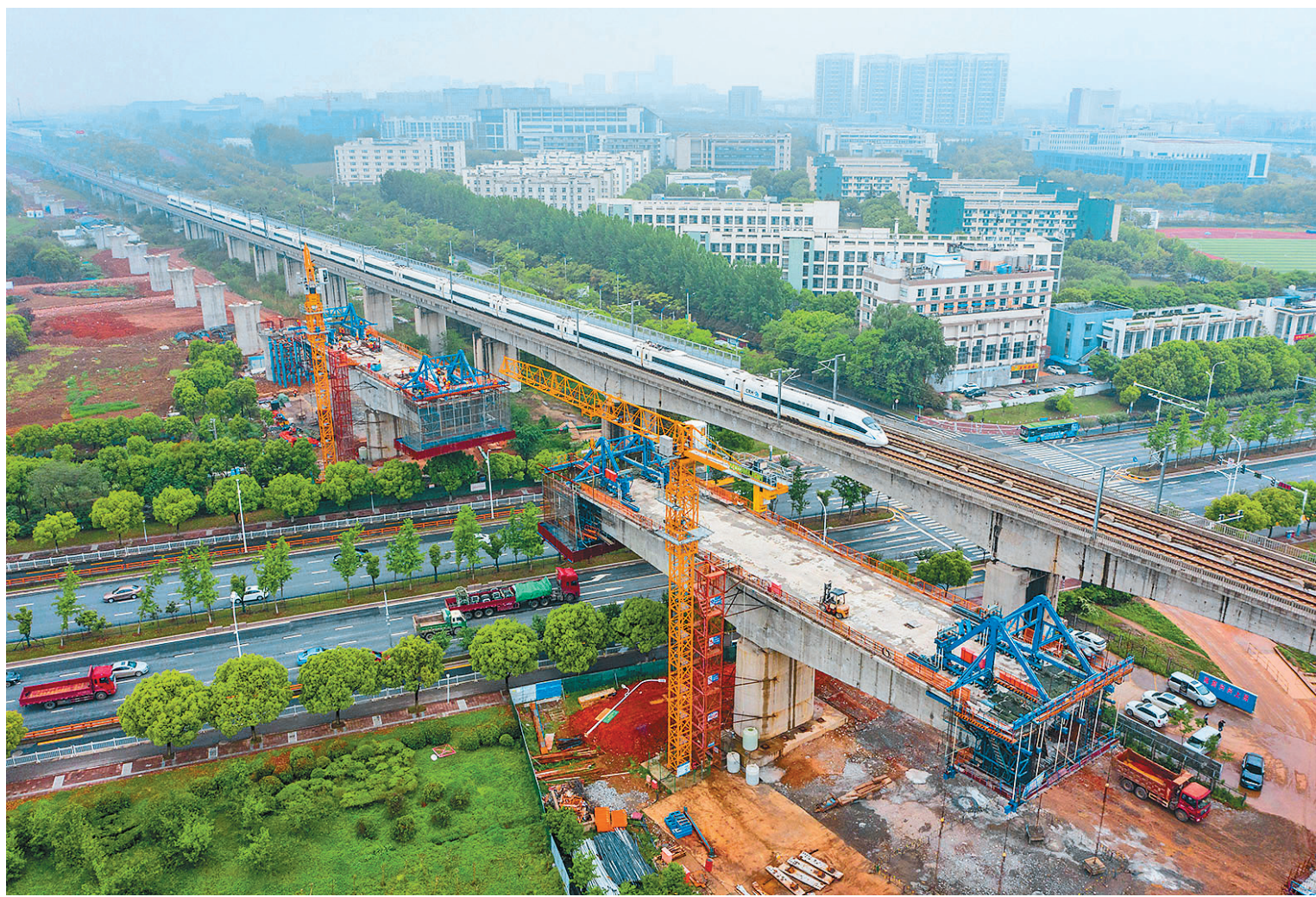
中铁四局四公司的工程人员在江苏南沿江城际铁路站前I标工程跨天元东路连续梁施工点施工作业。
