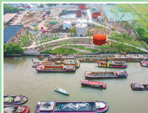
这是5月27日在浙江省杭州市拍摄的建设中的小河公园,该公园由一处工业遗存小河油库改造而成。
