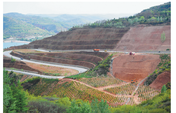
宁夏固原隆德县北象山历史遗留废弃矿山修复工程(5月11日摄,无人机照片)。
