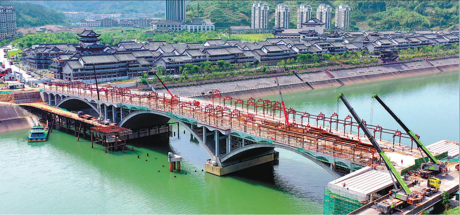
日前,位于景宁外舍区块,横跨千峡湖两岸的千照桥已完成总工程量的80%,预计7月份完工。千照桥西侧与G235国道相连接,东侧与外舍千湖路和畲乡古城规划路相连,建成后大桥两岸的路程将从原来的5公里缩短为不到300米,通行时间将缩短80%以上。同时将进一步完善区域路网结构,形成横跨千峡湖的景观廊道,为景宁全域旅游发展争光添彩。 记者 陈炜 通讯员 吴卫萍 毛文茹 摄
