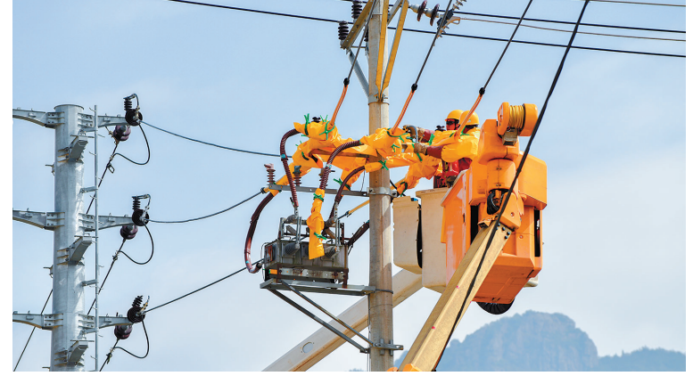
3月29日,国网遂昌县供电公司带电作业班在该县云峰街道石材加工园区开展带电更换开关,最大限度减少停电时间,保障园区正常使用。
