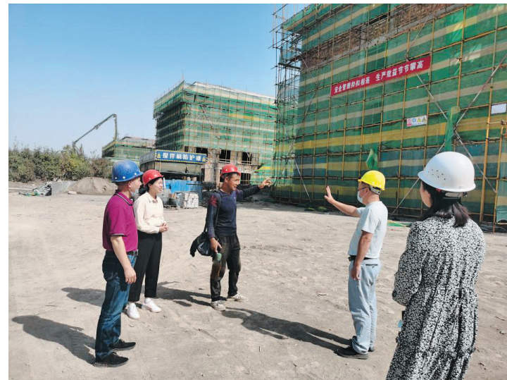
近日,市审计局在对口支援新疆和和县援建项目和资金审计过程中,重点关注援疆项目执行进度、资金绩效等情况,抽查丽水中学、丽水小学、塔什艾日克镇卫生院、县图书馆等援建项目建设情况,确保援疆资金合理配置、高效使用。图为审计人员在和和县丽水中学实地了解该项目施工进度。
