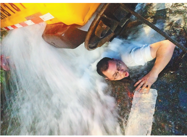
5月10日18时20分,庆元县新建路梁洲桥桥头,因车辆撞坏一消防栓导致严重漏水,大量水喷涌而出形成10多米高的水柱。为了不影响城区居民的用水,在不关闭主管阀门的情况下,庆元县给排水公司抢修人员顶着水柱下到窨井下,最终成功将阀门关闭。
