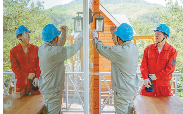
随着清明小长假的临近,遂昌各景点旅游人数逐渐增多,民宿用电量也随之上升。连日来,为保障民宿用电安全,国网遂昌县供电公司组织员工到民宿开展用电安全隐患排查,为民宿安全用电保驾护航。 记者 戴昕律 通讯员 祝灵潇 摄
