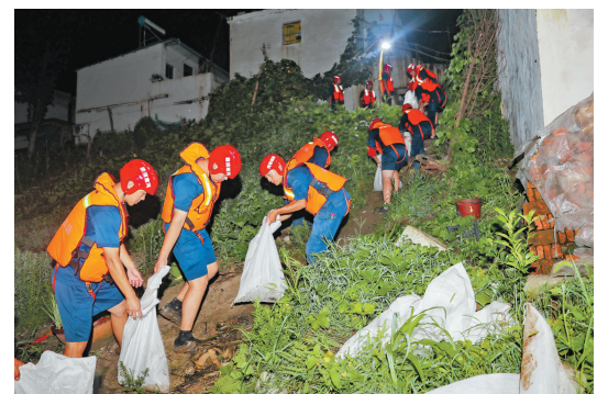
驰援安徽省阜南县抗洪的洛阳消防支队抗洪抢险突击队队员在部台乡毕台村保庄圩搬运物资封堵管涌(2020年7月20日摄)。
