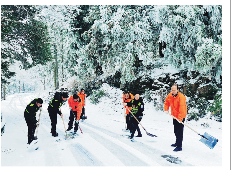
12月15日,在遂昌县公路新汀线、三长线、峡北线等路段出现不同程度的冰雪、冰冻,该县交通运输发展中心及时派出应急抢险队伍,清除道路上的冰雪和清理被冰雪压倒的毛竹等,确保公路安全畅通。记者 雷宁 特约摄影记者 章建辉 摄
