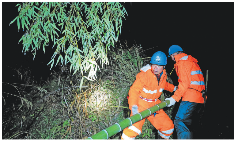
12月14日,受低温寒潮影响,景宁畲族自治县部分高海拔地区毛竹覆冰后倒伏在供电线路上,对供电造成影响。国网景宁县供电公司连夜出动,对受影响供电线路进行特巡,清理线路通道,及时抢修恢复供电。通讯员 陈龙伟 摄
