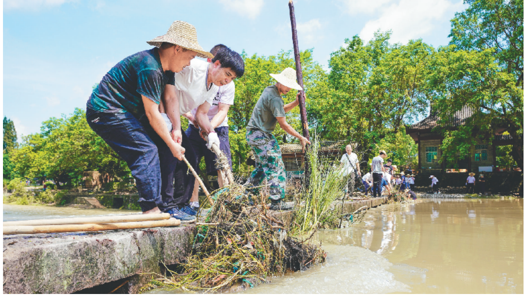
受今年第9号台风“利奇马”影响,仙都景区水位暴涨,造成在建项目被淹,道路、地面、监控、路灯等旅游基础设施损毁。8月12日,仙都景区工作人员和当地党员干部灾后第一时间开展自救工作。记者 雷宁 通讯员 许小峰 摄
