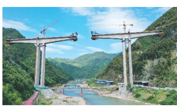
日前,省重点工程G235国道景宁至溪口段改建工程施工现场,工人们在大赤大桥工地施工。目前,大赤大桥已完成施工近80%,整座大桥预计将于今年9月实现合龙。
