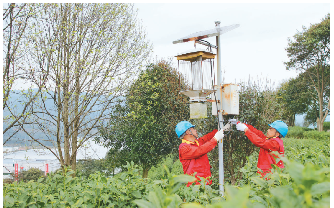
时下是茶叶加工高峰期,为保障茶企用上放心电,龙泉市供电公司兰巨供电所红船共产党员服务队义务为茶叶加工企业检修用电设备,用心做好“三服务”活动。
