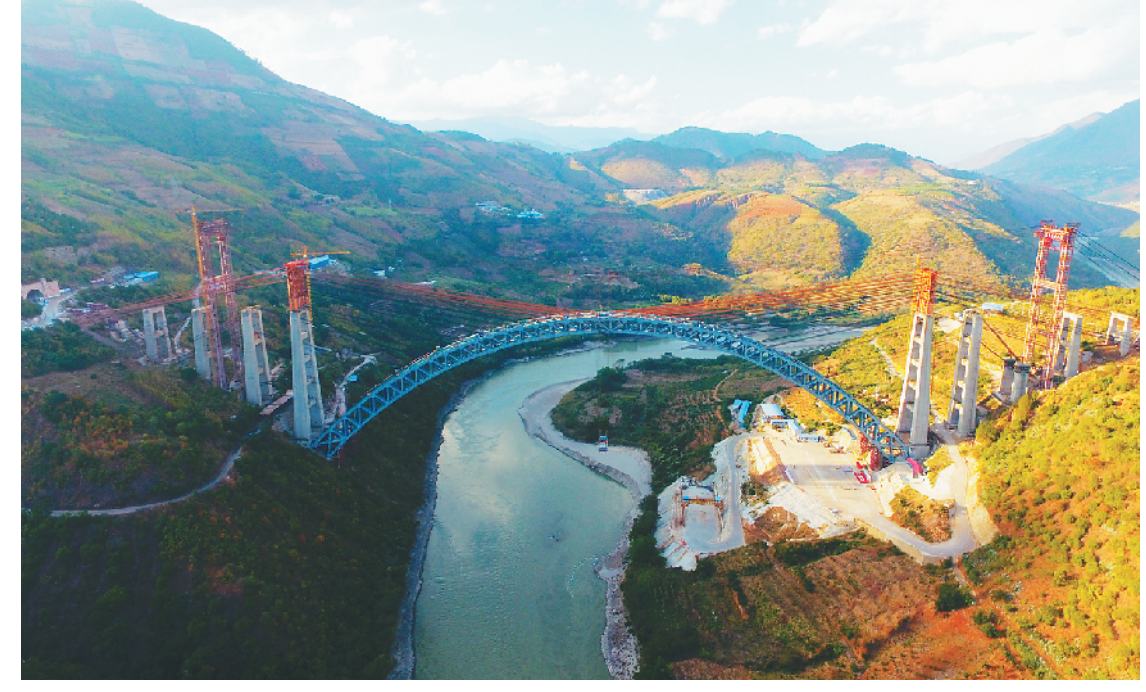
大瑞铁路怒江四线特大桥(12月9日无人机拍摄)。 12月10日,云南大理至瑞丽铁路全线重点控制性工程——怒江四线特大桥钢桁拱顺利合龙,标志着我国“一带一路”中缅国际铁路通道建设取得重大进展。大桥主跨为单跨达490米的钢桁拱,一跨飞越怒江天堑,是目前世界上铁路拱桥的最大跨度。
