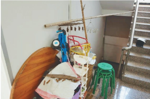
消防通道堆满了杂物
