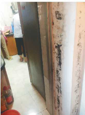
老周家的墙体渗水严重。
