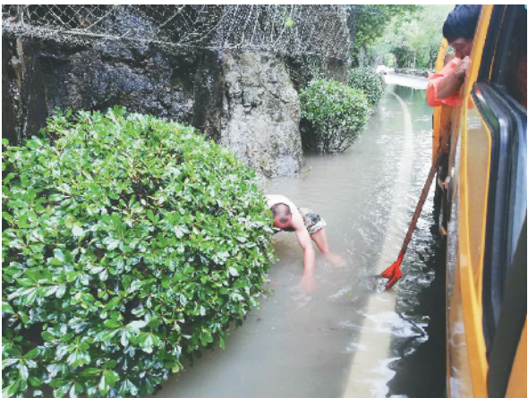
云和丽浦线一涵洞被堵,养护工用手和竹竿掏出堵塞物。
