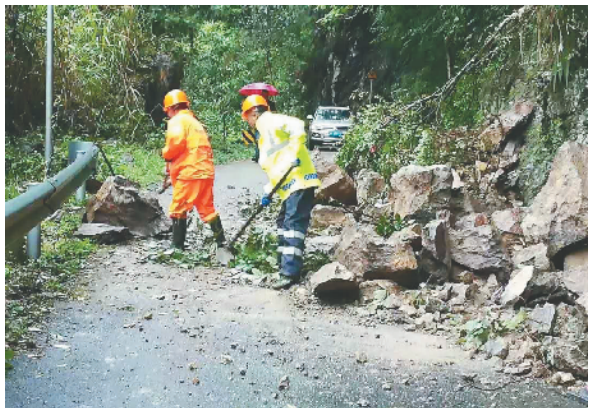
景宁公路应急抢险人员在县道东桥线清理塌方。
