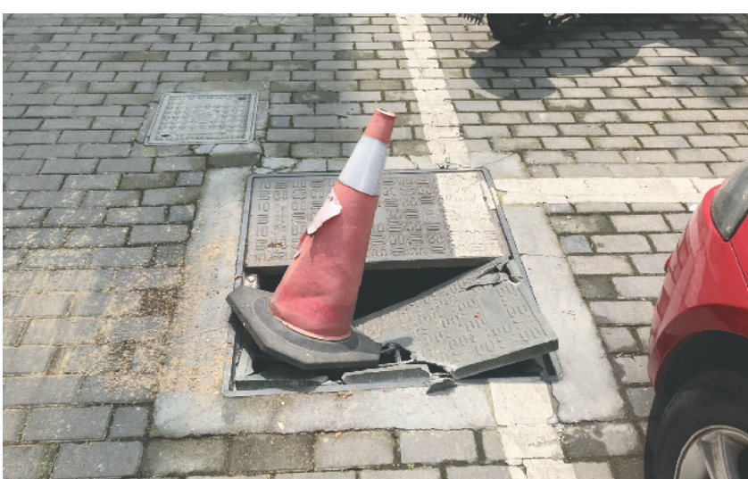
井盖已有一半破损,上面放有一个橙色的锥形筒。
